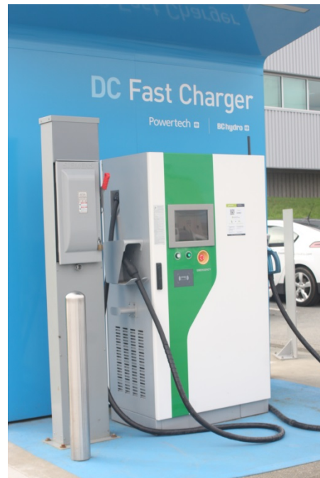
Une station de recharge pour les véhicules électriques aux laboratoires Powertech à Surrey en Colombie-Britannique.
